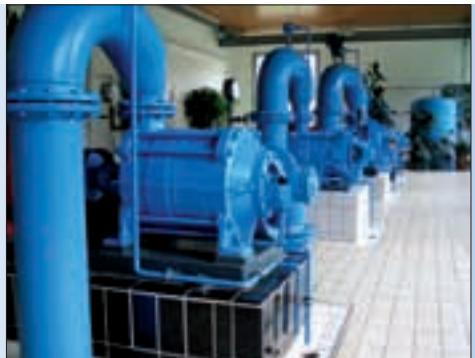
Pumpenhalle im Wasserwerk
