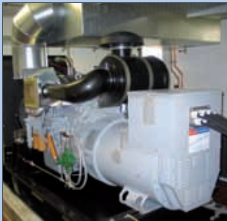
Notstromaggregat im Wasserwerk
