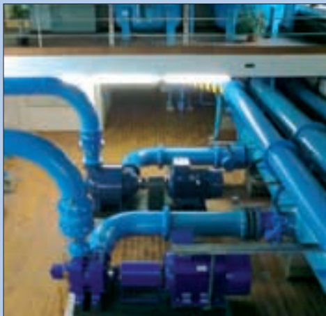
Rohrkeller im Wasserwerk
